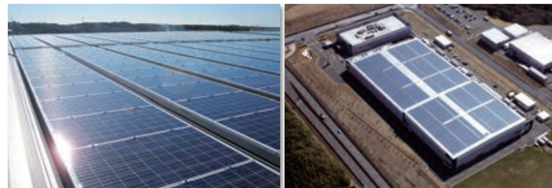
「工場棟」の屋根に設置された太陽電池モジュール
