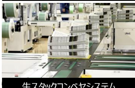
生スタックコンベヤシステム (発送仕分け)
